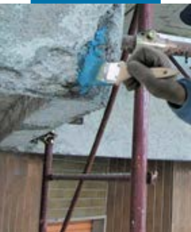
Aplicação a pincel de Mapefer 1K sobre ferros de armadura duma varanda em betão armado
