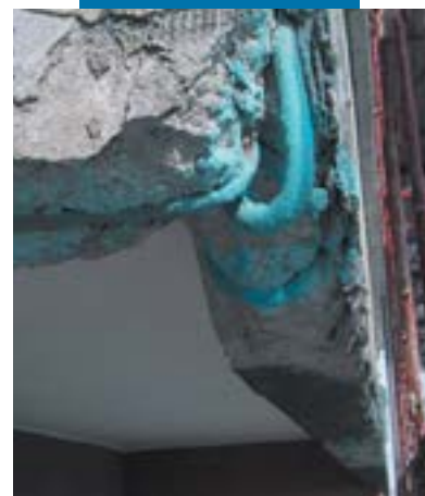
Ferros de armadura da frente duma varanda tratados com o Mapefer 1K
