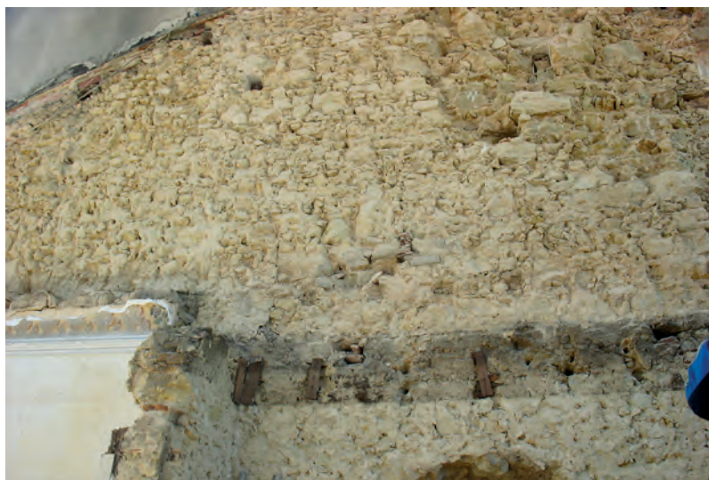
Suporte antigo com necessidade de regularização e consolidação
