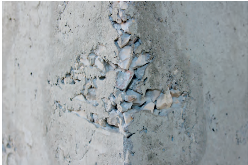
Perda de leitada em canto de pilar arquitectónico
